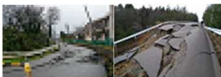
富来小学校横の 町道被害
